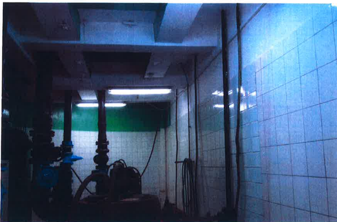
Pompownia centralna – komora pomp
