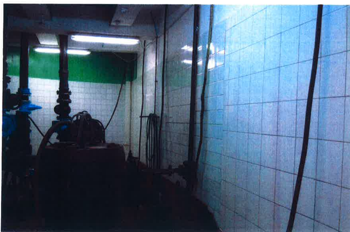
Pompownia centralna - komora pomp
